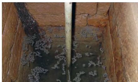
Einwuchs von Wurzelwerk links oben und unbekannte Verunreinigung des Quellsammlers
