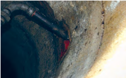
Nicht ausreichend abgedichtete Rohrdurchführung
