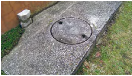
Risse in der Betoneinfassung führen zu Undichtigkeiten
