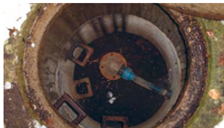
Wasser im Schacht, Wanddurchführung nicht dicht, Durchwurzelung Ringzwischenräume
