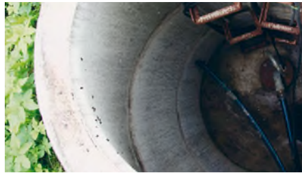
Schädlinge im Schacht durch nicht dicht aufliegenden Deckel
