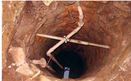
Korrodierte Rohre, starke Eisenoxidausfällungen
