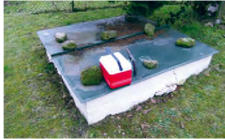
Undichte, mangelhafte Abdeckung
