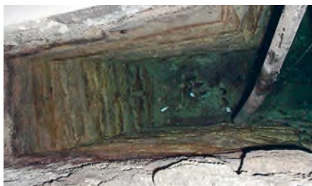
Quellschacht mit baulichen Mängeln
