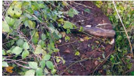
Korrodierte, nicht tagwasserdichte Abdeckung
