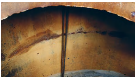
Feuchtigkeitseintritt zwischen Schachtringen
