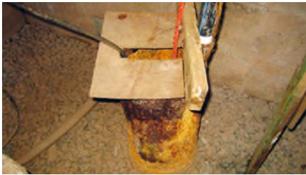
Mangelhafte Abdeckung Brunnenrohr
