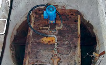
Stark verschmutzte, offene Holzabdeckung
