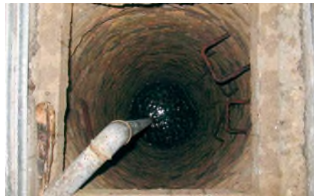
Eisenteile in Schachtbrunnen
