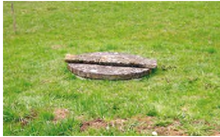
Betondeckel nicht tagwasserdicht
