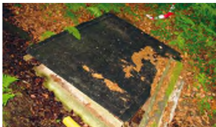
Unzureichende Abdeckung und provisorische bauliche Gestaltung einer Quellfassung
