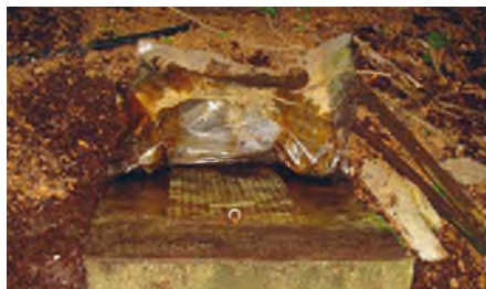
Quellfassung mit undichter Abdeckung und Gefahr des Überspülens (Hanglage)
