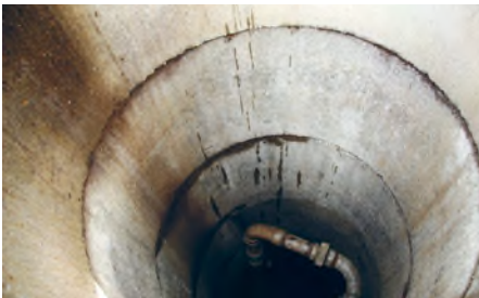
Feuchtigkeitseintritt zwischen Schachtringen
